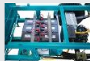
Batterieeinheit unter der Ladefläche
